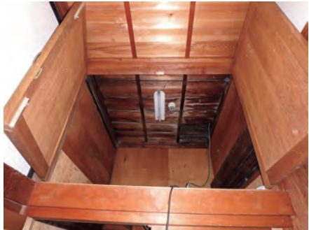
写真 47 現状 北西物置の天井
