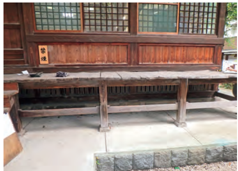
写真74 現状 濡れ縁 束・貫の削れ
