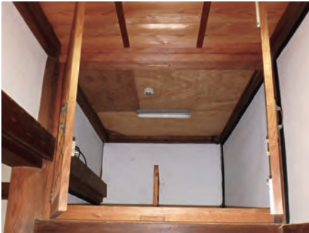
写真 48 現状 北東物置の天井
