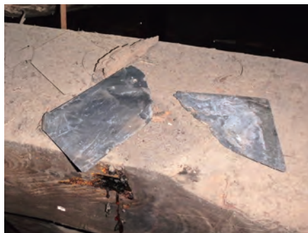
写真 32 小屋裏で見つけた天然スレート破片
