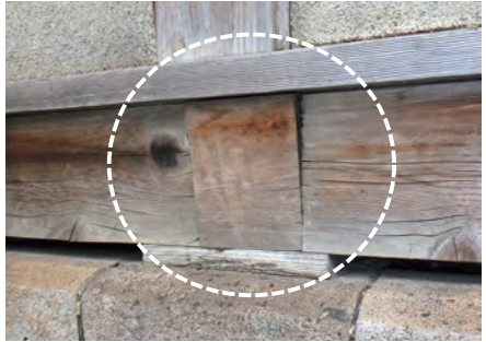
写真 70 現状 土台埋木
